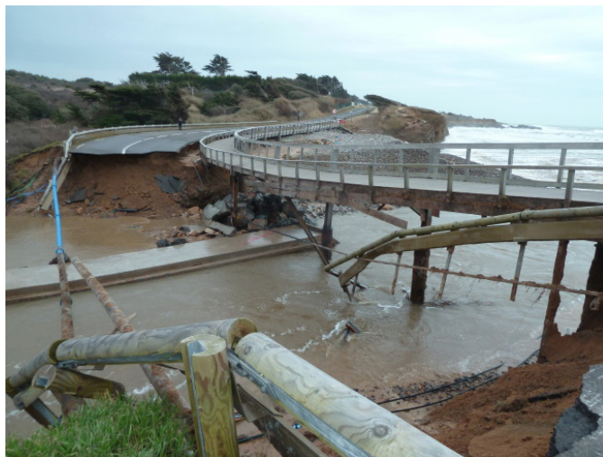
Photo 1. État de la route au-dessus de l'Anse de Cayola le 14 février 2014. © CACO
